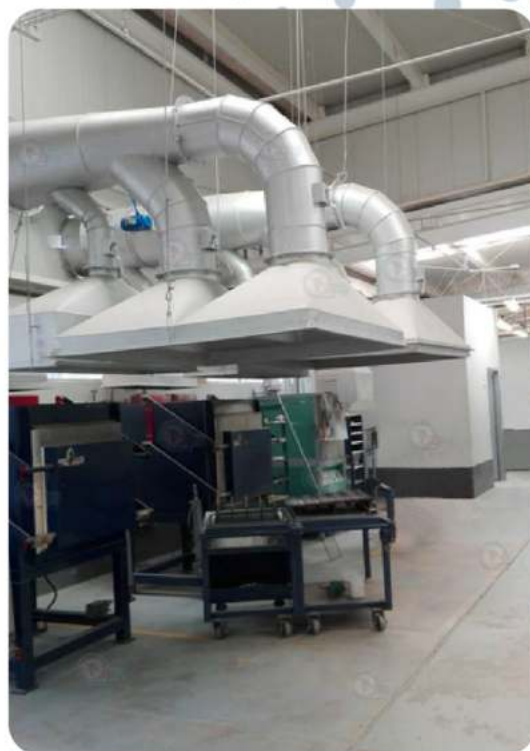
Sistemas de extracción
