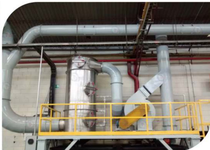
Lavadores de gases
